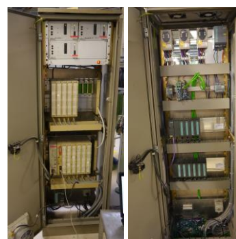
Schaltschrank vorher und nachher
