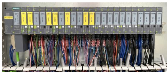
abgesetzte Peripherie auf Basis ET200-SP
